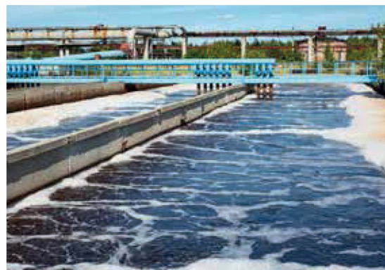
Очистка сточных вод
